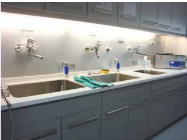
Typischer unreiner Arbeitsplatz einer Endoskopiaufbereitung
