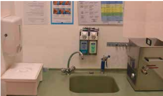
Typischer unreiner Arbeitsplatz mit teilmaschineller Aufbereitung (Vorreinigungswanne, Reinigungsbecken, Spritzpistole, Ultraschallbecken)
